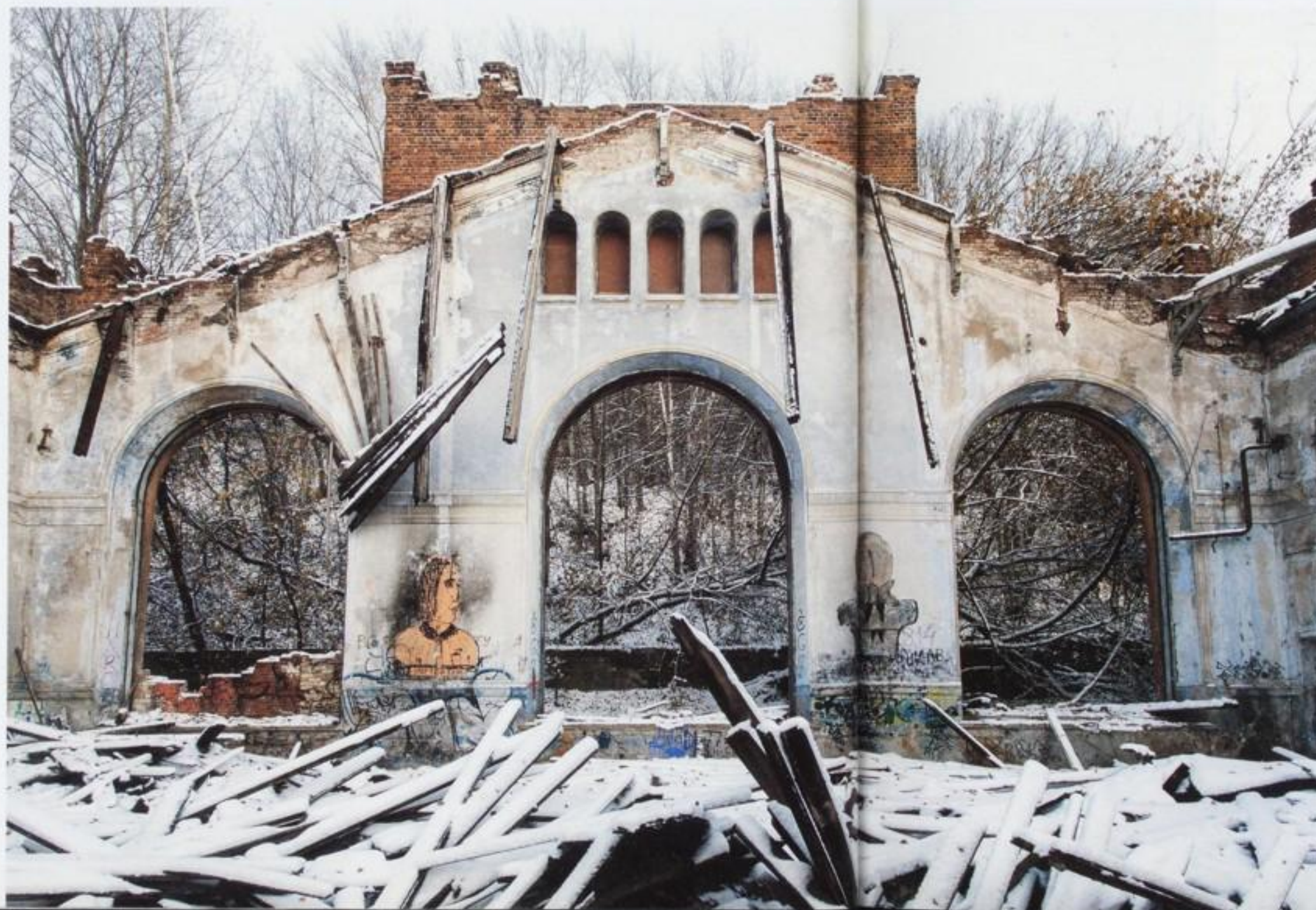
Здание, относившееся к водонапорной башне, скоро разрушится до основания. Под досками уже шумит вода. Работы 0331C, TOY и Muddleband
